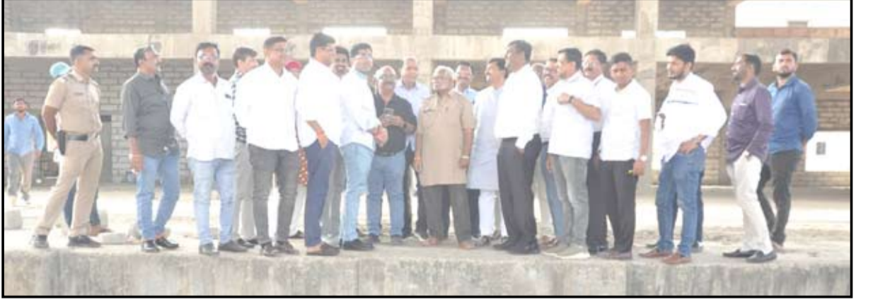
प्रोफेसर कॉलनी चौक येथील मनपाच्या नाट्यसंकुल कामाची आ.संग्राम जगताप यांनी पाहणी केली. (छाया - लहू दळवी)
